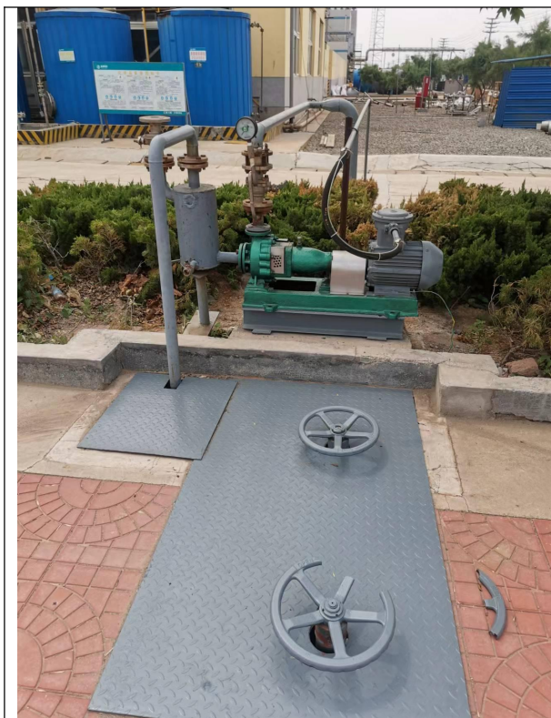
事故水池（地下）
