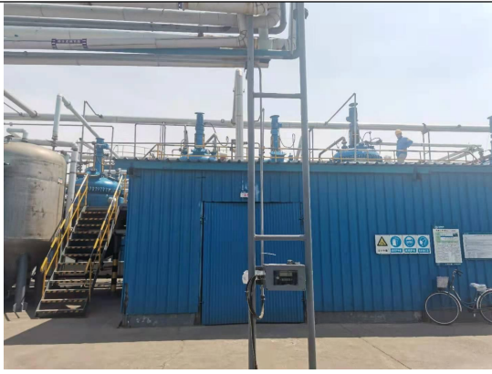
厂区污水处理站 2
