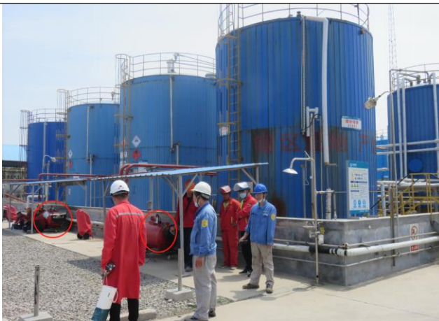
罐区应急消防设施
