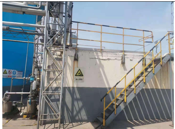
厂区污水处理站 1
