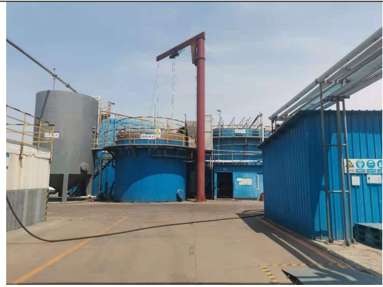
厂区污水处理站 3
