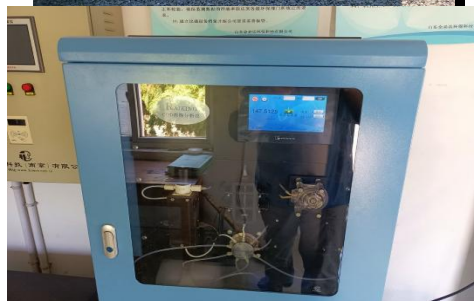
污水在线设施
